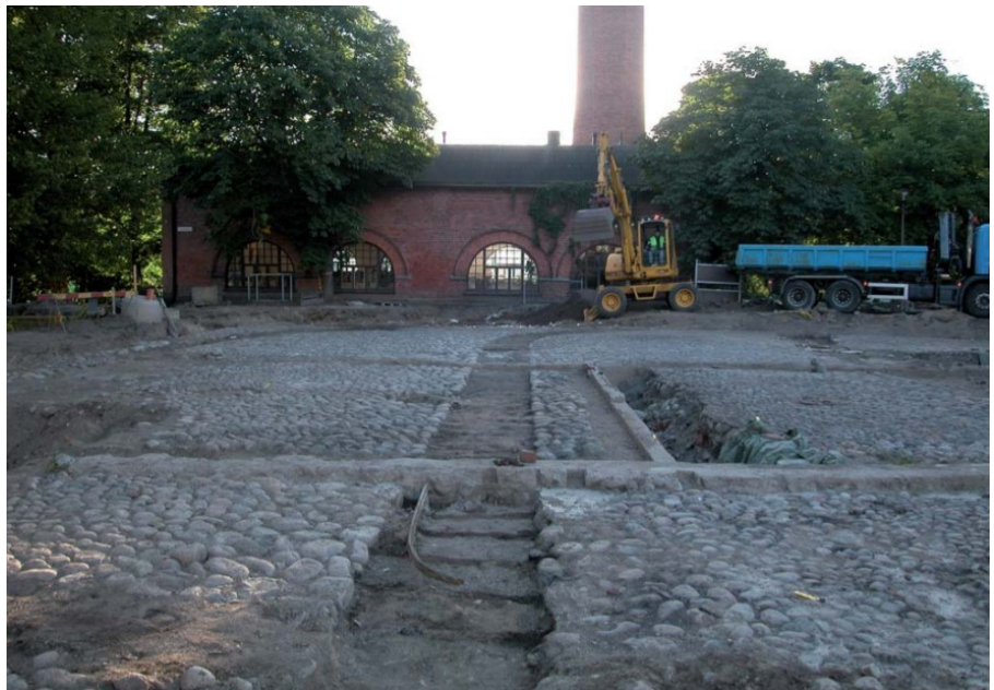
Kuva 13. Kustaa III:n aukiolla sijaitseva kenttäkivevyys ja kapearaiteisen rautatien osia. Rakenteita peittää nykyisin tekonurmi. (Kalle Luoto)
